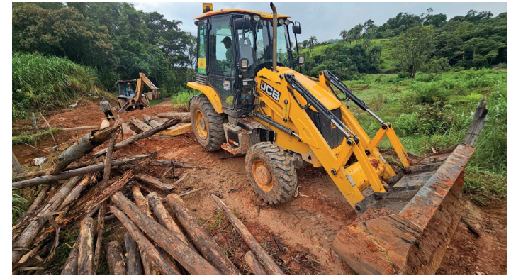
Quedas de árvores e obstruções de vias estão entre as ocorrências atendidas | PMSN
