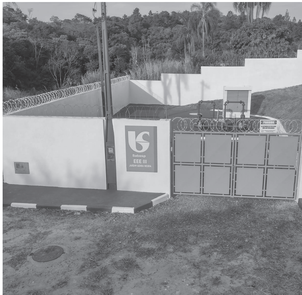
Estação de Esgotamento da Bacia do Prata está localizada no Bairro das Posses | Prefeitura de Serra Negra
