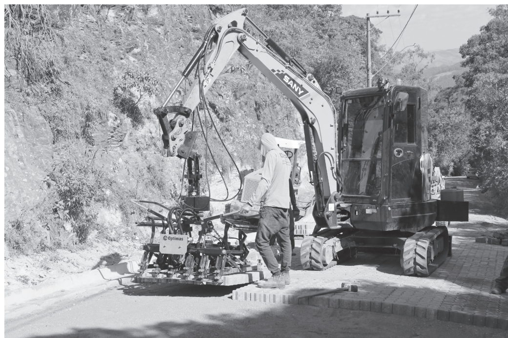
Bloquetes intertravados garantem mais segurança e conforto para o tráfego de pedestres e veículos | Prefeitura de Serra Negra
