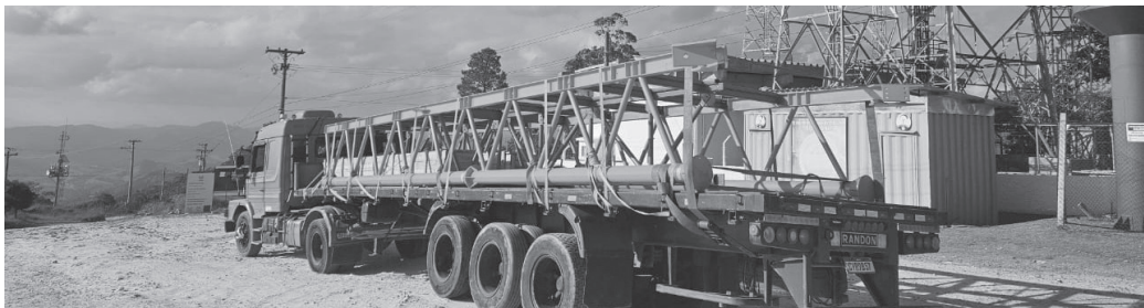
Materiais fundamentais para a sustentação da plataforma de vidro já estão no local onde está sendo construído o novo mirante turístico | Prefeitura de Serra Negra
